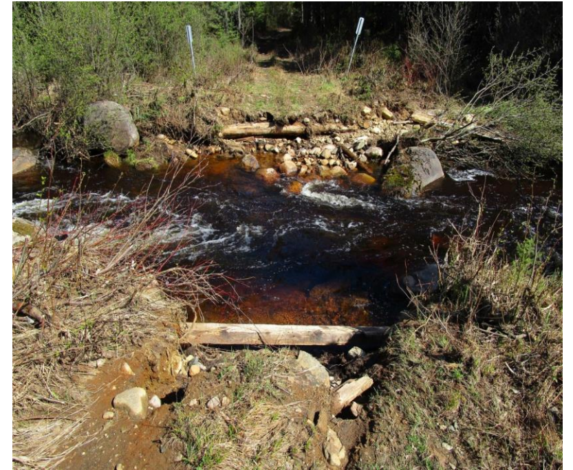
Crue soudaine emporte un ponceau, Mauricie (2022)
