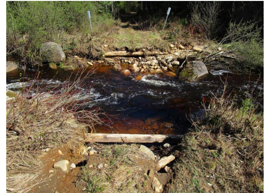
Ponceau arraché lors d'une crue, Mauricie (2022)
