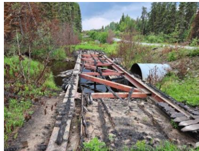
Pont brûlé, Baie James (2023)
